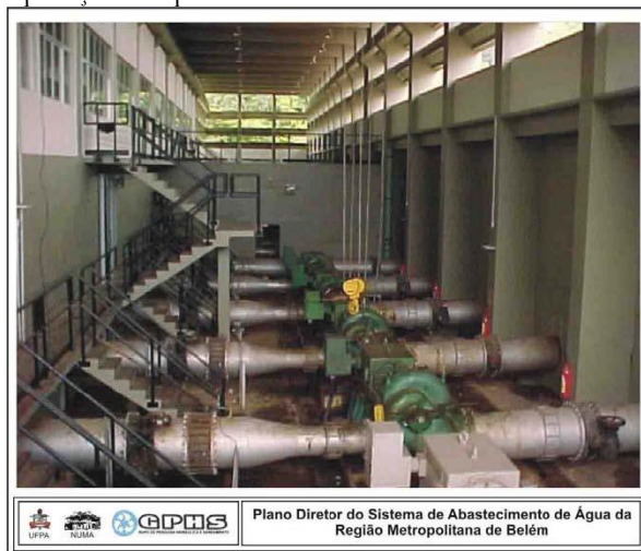
Fotografia 7 – Conjuntos Motor e Bomba com operação em paralelo
