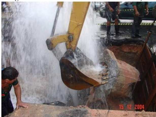
Fotografia 10 – Vazamento em rede de distribuição de água
