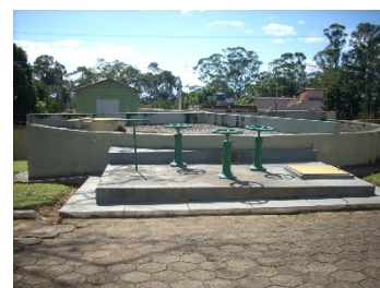
À esquerda: Captação em balsa (EEAB) típica
