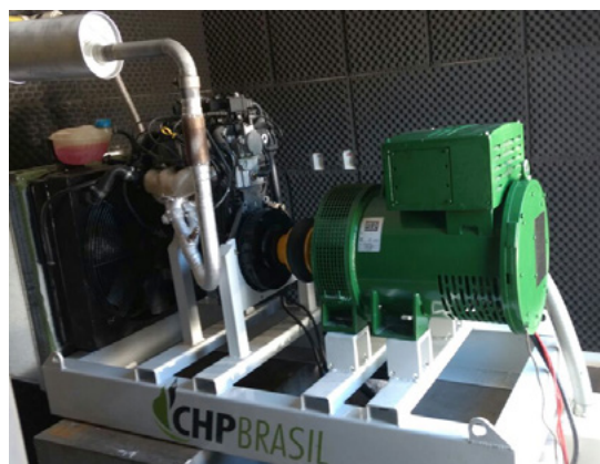
Figura 21: Grupo motogerador de energia elétrica movido a biogás instalado na ETE Ouro Verde – Foz do Iguaçu
