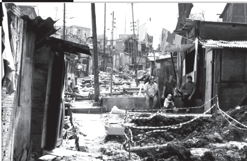
Favela Tamarutaca (núcleo consolidável) – Santo André. Remoção de famílias para abertura de viário.
